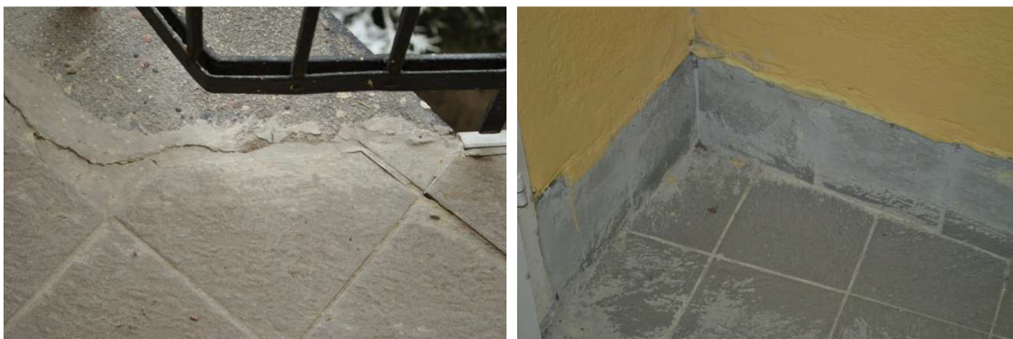
39. Műkö szegély és burkolatcsatlakozása, és letisztítatlan burkolat, lábazat rugalmas fugák nélkül
