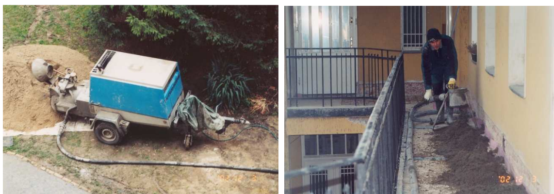
25. Az esztrich-betont előállító berendezés a szállítócsővel, a szórófejjel történő betonozás a betonacélháló és a peremszigetelés elhelyezését követően
