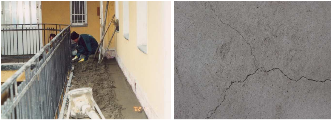
26. Az esztrich-beton bedolgozása, simítása vezetősávok között, valamint zsugorodási repedései
