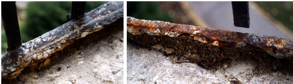
17. Korrózió melegen hengerelt acél szegélygerenda fejlemezein a feltárás után
