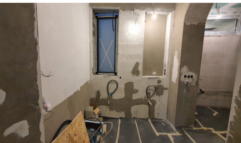
Befejezetlen épületgépészeti szerelések
