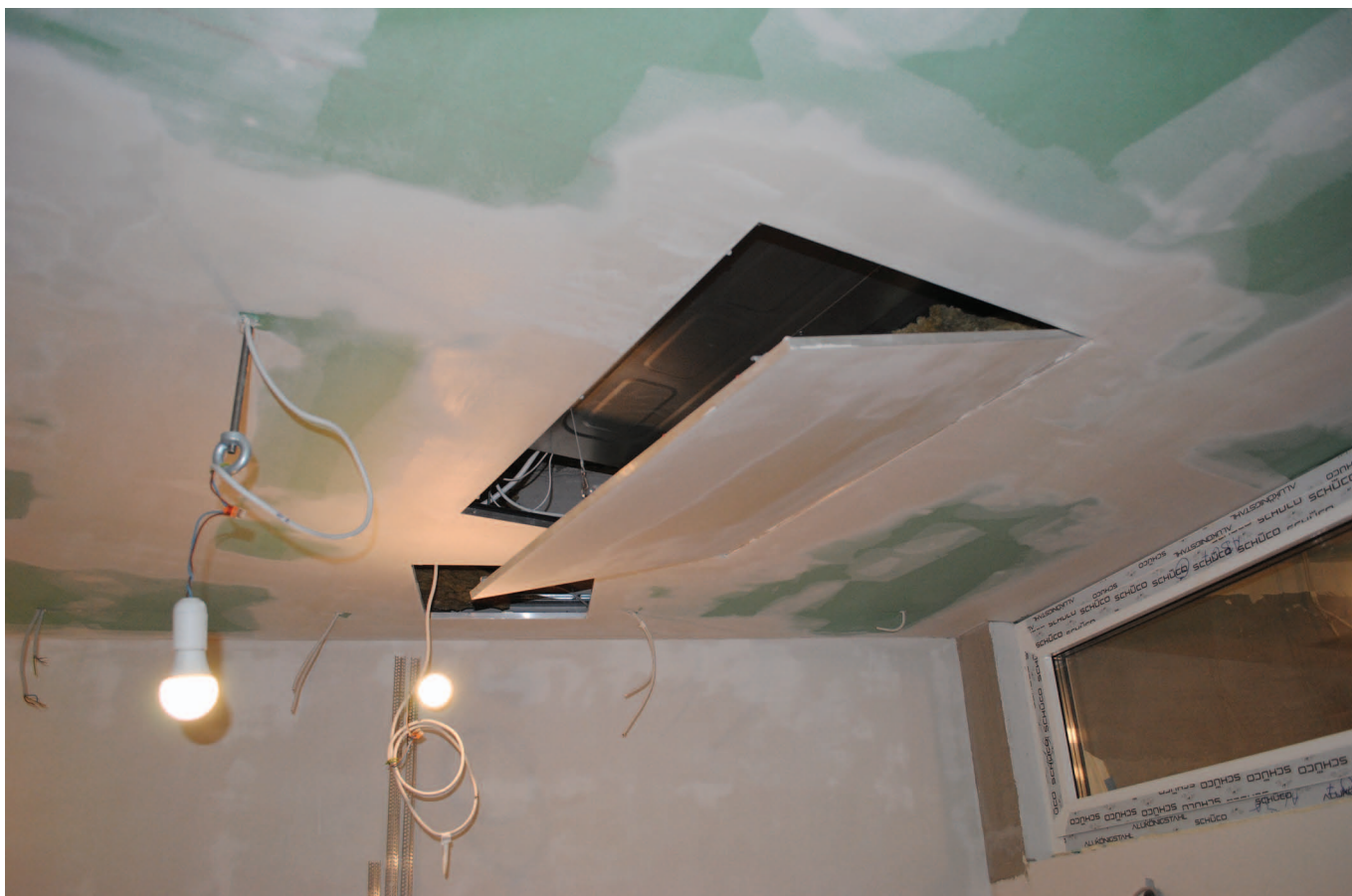
A konyha és a fürdő között helytelenül beépített bevilágítóablak
