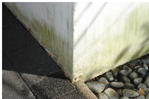
A DK-i homlokzati falon a hőszigetelés és az algásodás
