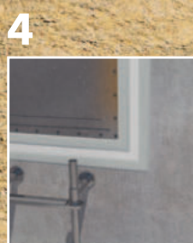
Csatlakozási hézag beton-acél
