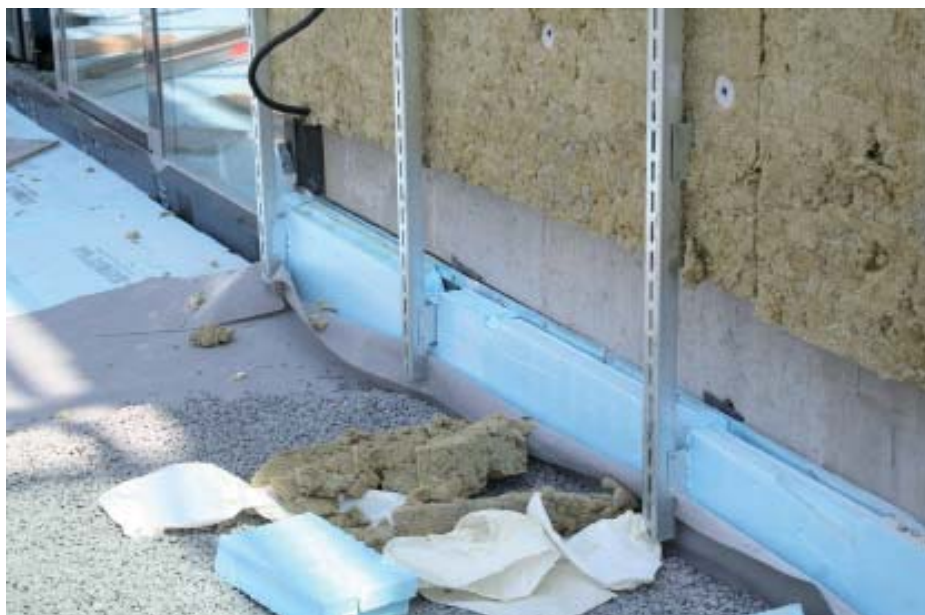
A homlokzat hátszerkezete a rendezett terepszint alatt szúrja át a szigetelést
