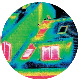
Hőhíd a kémények és az álló ablak kapcsolatánál (külső felvétel)
