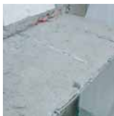
Balkon konzollemek helyreállítás előtt
