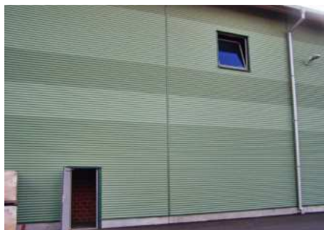
Eredeti, magasan beépített, hatástalan ablak
